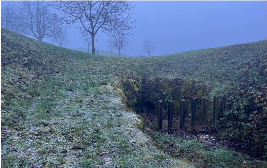
Abbildung 6: Foto der Schwachstelle bei der Eindolung oberhalb der Chlösterlistrasse am Ort Pfaffenhaut. Blick in Fliessrichtung. Quelle: Flussbau AG, 18.12.25
